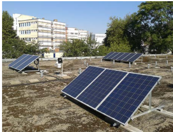
1. ábra. A telepített napelemes rendszer (külső és belső részek)
